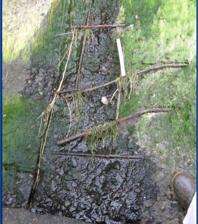
Grade F - Apron
