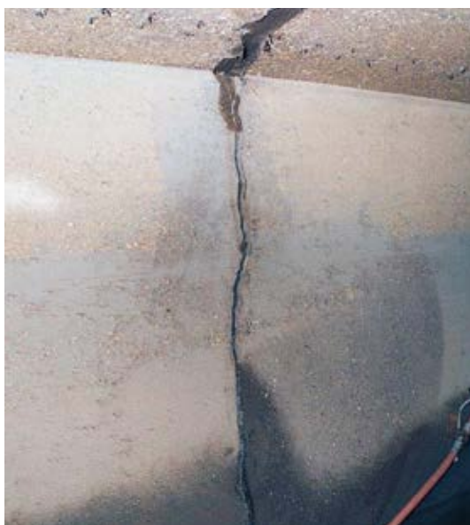
Fig. 3: Fracture in raw-water conduit
